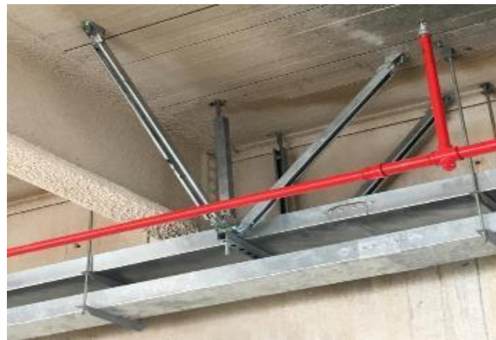
抗震支吊架现场图片
